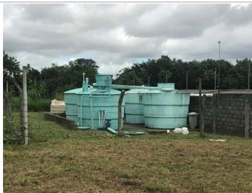
Vista Geral – Estação de tratamento de esgoto
