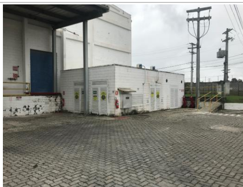
Vista Geral – Subestação
